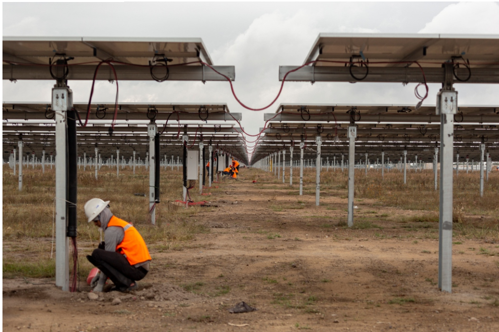
PLANTA SOLAR FOTOVOLTAICA PACHAMAMA - Aguascalientes - México
